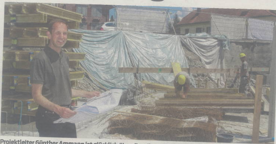
Projektleiter Günther Ammann ist glücklich über die reibungslose Ausführung der bisherigen Bauarbeiten.
